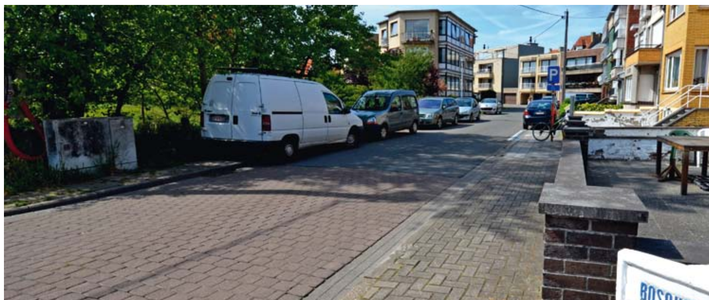
Bosquetiastraat - Het project omvat de heraanleg van de Bosquetiastraat en de Vlaanderenstraat (tussen de Bosquetiastraat en Kursaal). Er komt een gescheiden rioleringsstelsel. De rijweg wordt heraangelegd in asfalt. De voetpaden en parkeerstroken worden aangelegd in kleinschalig waterdoorlatende materialen. Er wordt eenrichtingverkeer ingevoerd, uit de Vlaanderenstraat en de Blickeklaan richting Lalouxlaan. Raming 390.483 euro. Unaniem.
